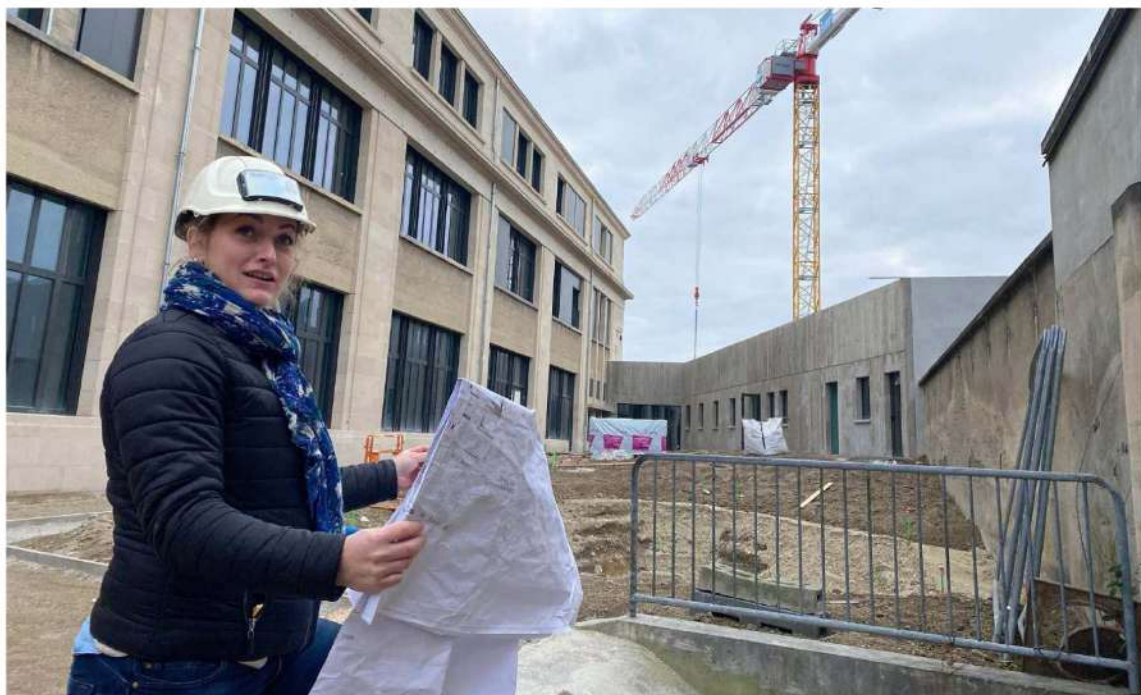
Camille Brosse est conductrice travaux pour Le Bâtiment Associé à Reims (Marne).
